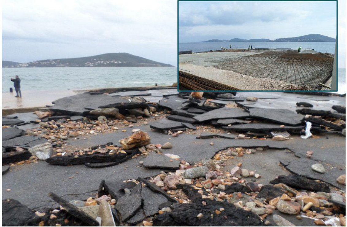
Kınalıada yük çıkarma iskelesi lodosun etkisiyle kullanılamaz hale gelmişti. İBB görevlileri tarafından uzun bir zaman harcanarak eskisinden sağlam duruma getirildi
